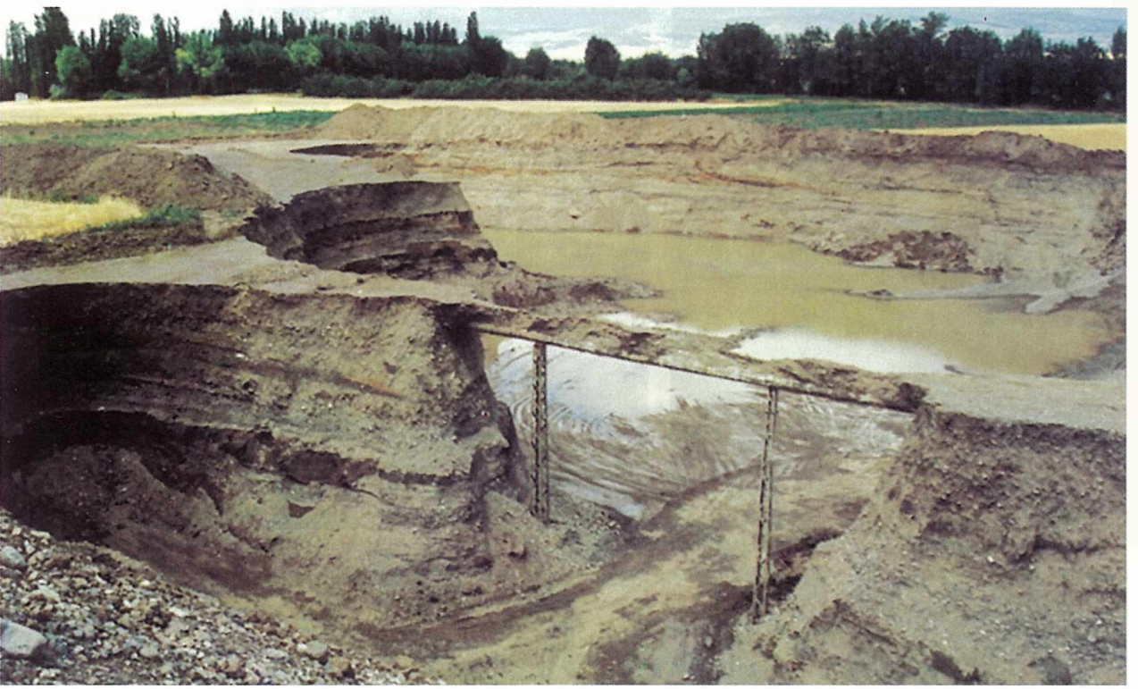
İçören Köyü (Kazan-Ankara) yakınında, akarsu yatağı dışında alüvyon akiferin kazılması sonucu, civarda bulunan ve Ankara'ya içme suyu sağlayan kuyuların iletim borularının açığa çıkması. Borular, ocak işletmecisi tarafından dikilen demir direklerle şimdilik ayakta durabiliyor.
